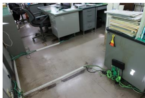
OAフロア未対応による露出の床モール*
