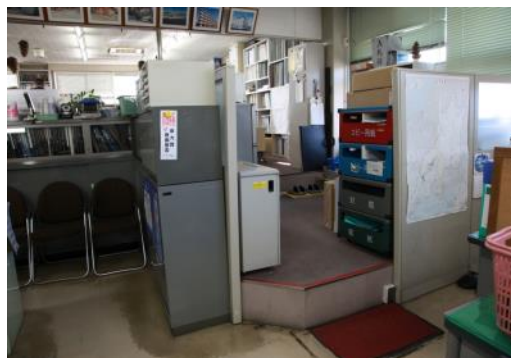
執務室内の段差
